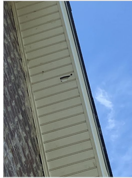
Hole in soffit.
