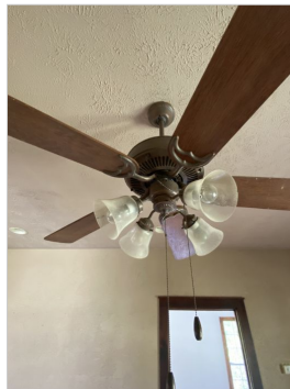
Living room ceiling fan wobbles.
